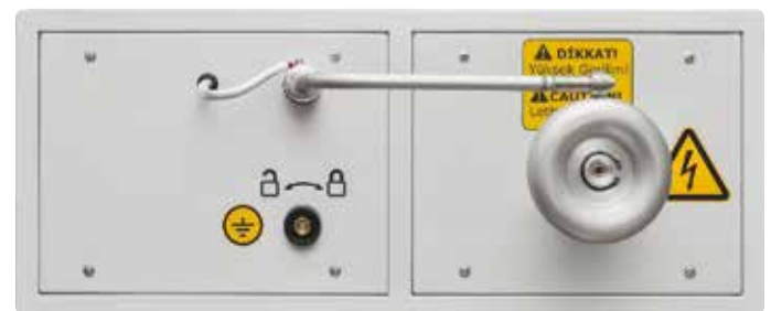
Widoczne ramię uziemienia
